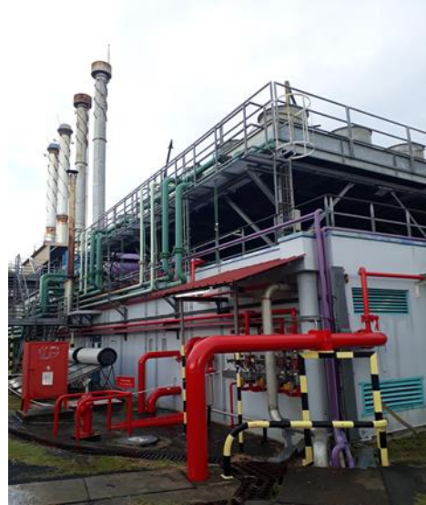
Centrale de Badamiers
